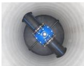
Колодец 1200 с установленной задвижкой d_{y200}
