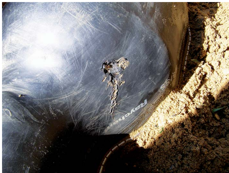
Рис. 4. Повреждение оболочки кабельной муфты CFJ x-245 в целом месте (вода в муфте) линии 220 кВ ТЭЦ-21 — «Дубнинская-1» (Москва)
