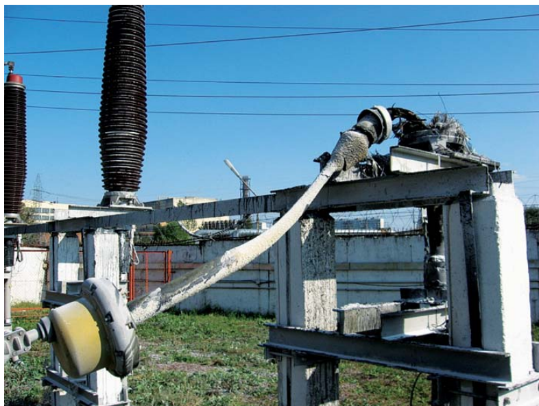
Рис. 3. Повреждение концевой кабельной муфты 220 кВ АРЕСВ-2456, фаза «Ж» линии ТЭЦ-21 — «Дубнинская-1» (Москва)
